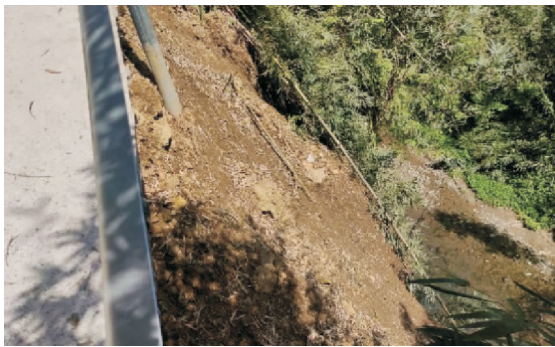
图10 梅垌镇龙尾村乡道边坡垮塌
