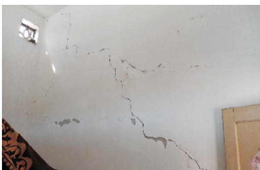
图4 仙峰苗族乡兴底路附近砖混房屋裂缝
