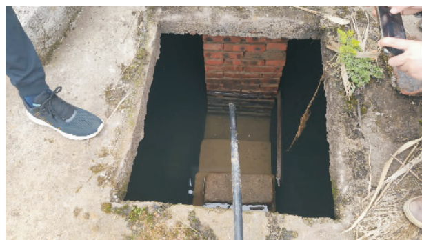
图 14 九丝城镇迎春村水窖裂缝渗水
