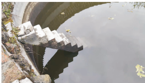
图 15 仙峰苗族乡高山好村蓄水池裂缝渗水
