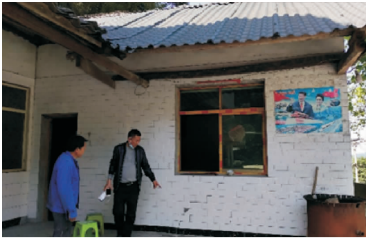
图8 梅垌镇中坪村砖木结构房屋墙体贯穿裂缝
