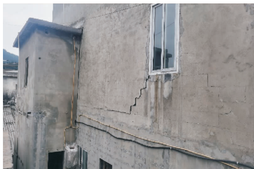
图7 仙峰苗族乡仙峰村砖混房屋贯穿裂缝
