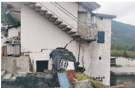
图6 仙峰苗族乡仙峰村砖混房屋贯穿裂缝
