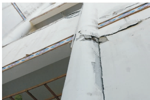
图3 仙峰苗族乡框架结构房屋梁柱结合部位裂缝
