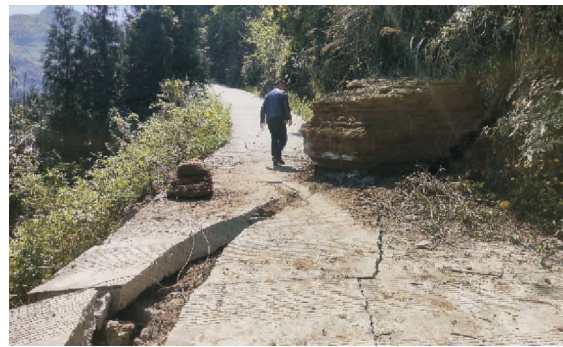
图11 梅垌镇中坪村3组乡道因巨石崩塌受损
