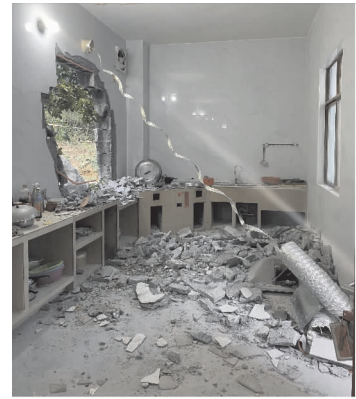
图4 次生灾害对房屋的破坏
