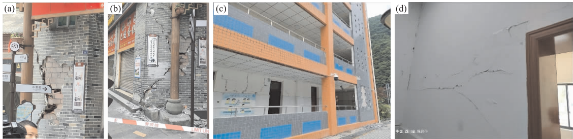
图 2 框架结构破坏典型照片
