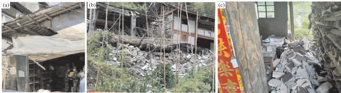
图 4 木结构破坏典型照片
