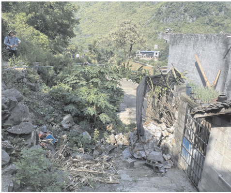
图2 地震直接破坏墙体
